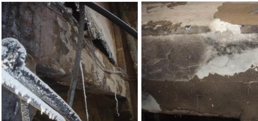
Рис. 5. Характерные разрушения строительных конструкций
