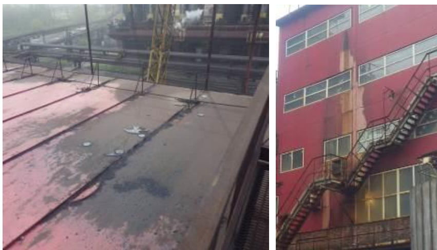
Рис. 8. Характерные повреждения кровельных и стеновых сэндвич-панелей
