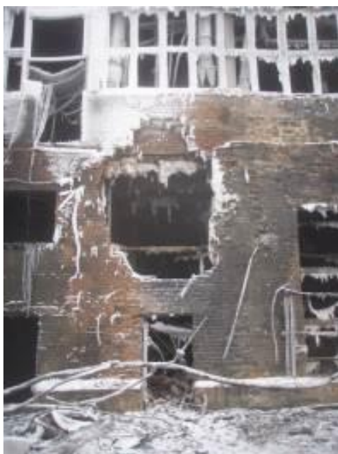
Рис. 6. Последствие попадания в здание части технологического оборудования
