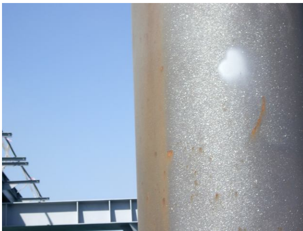
Рис. 5. Коррозия в зоне брызг
