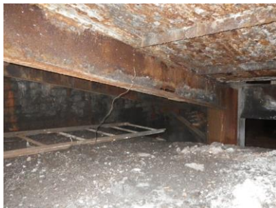
Рис. 5. Коррозия металлоконструкций перекрытия наклонной галереи
