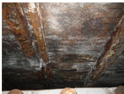
Рис. 7. Коррозия металлических балок, железобетонной плиты перекрытия наклонной галереи
