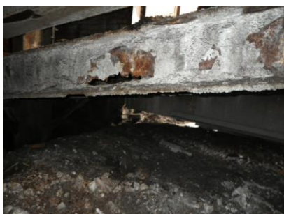
Рис. 6. Сквозная коррозия стенки балки перекрытия наклонной галереи
