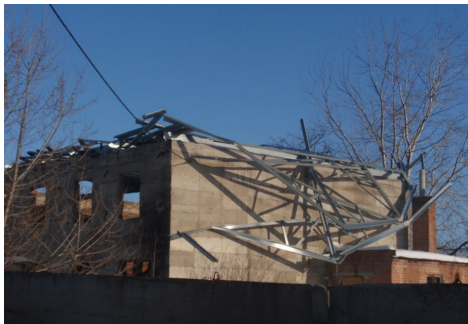
Рис. 1. Обрушение каркаса надстройки из ЛСТК на стадионе монтажа вследствие отсутствия системы связей
