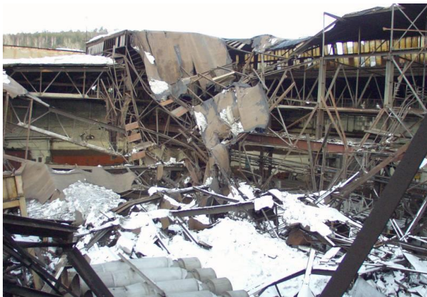
Рис. 5. Обрушение покрытия здания адьюстажа термокалибровочного цеха ОАО «Златоустовский металлургический комбинат»
