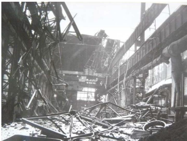
Рис. 4. Обрушение покрытия электросталеплавильного цеха в заводе ООО «Пензтяжпромарматура», г. Пенза
