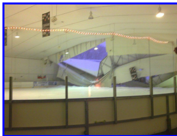
Рис. 4. Обрушение кровли ледового катка «Полюс», г.Владивосток
