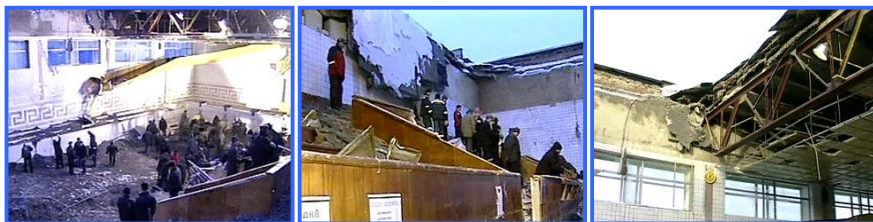
Рис. 5. Обрушение кровли бассейна «Дельфин», г.Чусовой
