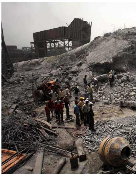
Рис. 17. Обрушение трубы на электростанции в г.Джханс, Индия
