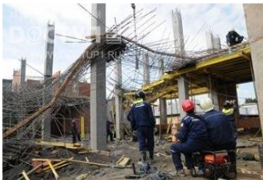
Рис. 9. Обрушение перекрытия строящегося жилого дома в г.Челябинск
