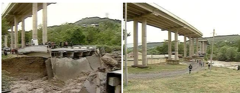
Рис. 19. Обрушение автомобильного моста через реку Глданула, г.Тбилиси
