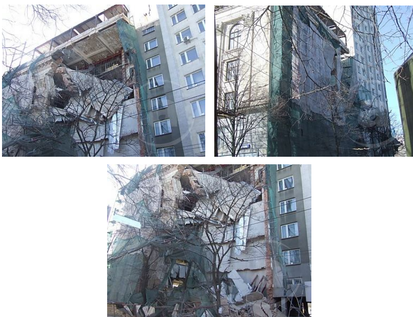
Рис. 6. Обрушение здания в г. Харьков
