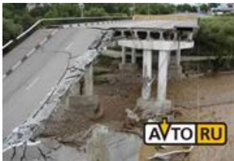
Рис. 20. Обрушение автомагистрали в г.Нанту (Тайвань)
