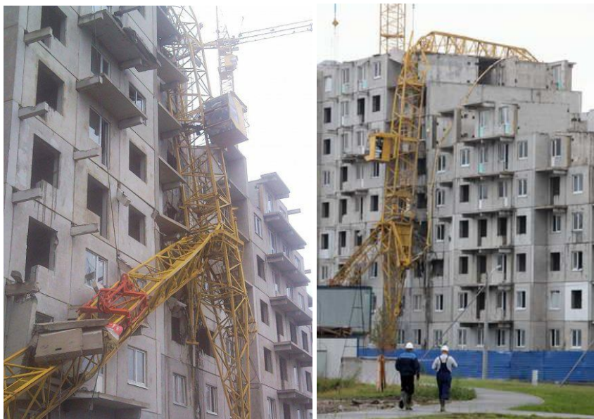
Рис. 22. Падение двух башенных кранов в г. Санкт-Петербурге
