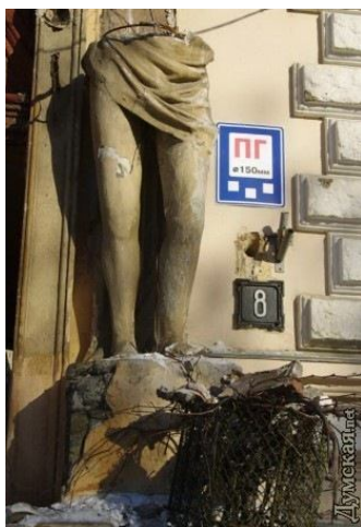
Рис. 11. Обрушение опоры старинного здания
