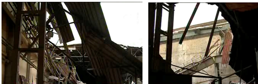
Рис. 15. Обрушение кровли в недействующем капитально ремонтируемом цехе Кировского завода
