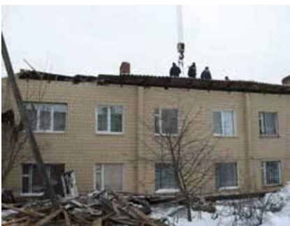
Рис. 5. Обрушение крыши жилого двухэтажного дома в г.Чернигов
