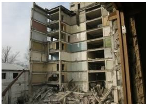
Рис. 1. Обрушение 8-этажного здания
