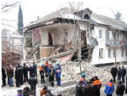
Рис. 3. Обрушение несущих конструкций двухэтажного жилого дома в г.Тбилиси, Грузия
