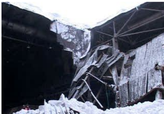
Рис. 16. Обрушение крыши цеха термообработки г.Красноярск
