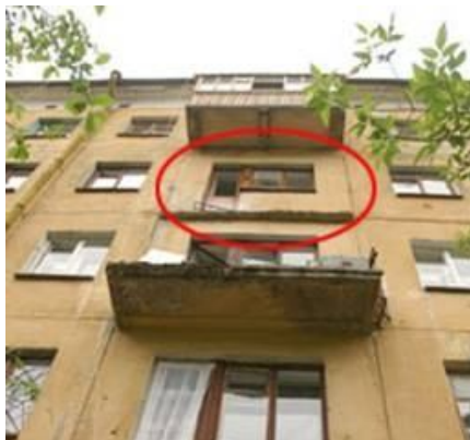
Рис. 13. Обрушение балкона жилого дома в г.Пермь
