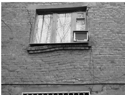
Рис. 2. Разрушение кирпичной кладки простенка в месте опирания металлической оконной перемычки на стену, искривление горизонтальных и вертикальных швов кладки стены, трещины из-за неравномерных осадок
