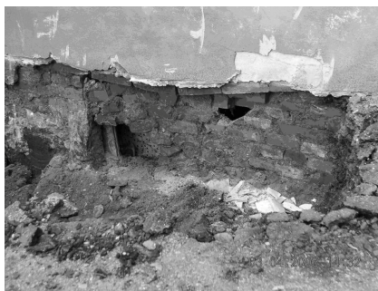
Рис. 3. Разрушение кирпичной перемычки слухового проема в наружной стене подвального помещения. (Обнаружено при вскрытии шурфа)
