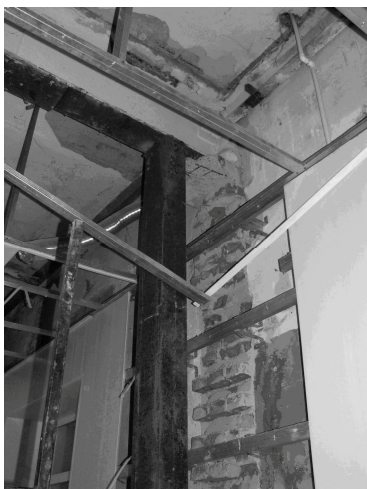
Рис. 5. Удалена кирпичная пилястра, поддерживающая несущую металлическую балку перекрытия. Установлена временная металлическая стойка
