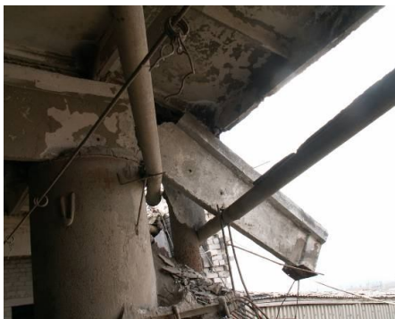
Рис. 8. Разрушение элементов покрытия в результате обрушения наружной стены здания растворобетонного узла
