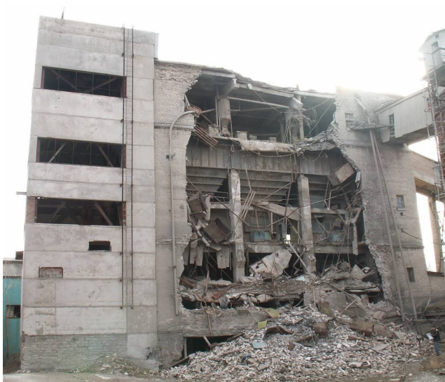
Рис. 7. Здание растворобетонного узла (литер Э) по ул. Харьковское шоссе, 15а в г. Новочеркаске Ростовской области со стороны обрушившейся стены
