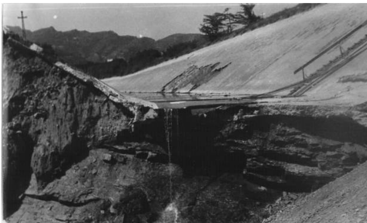
Рис.2. Разрушение ложа деривационного канала Земо-Авчальской ГЭС
