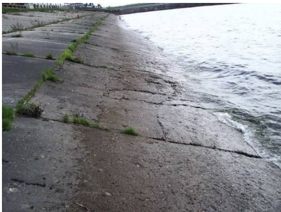
Рис.3. Просадка плиты крепления откоса. Образование трещин на поверхности плиты
