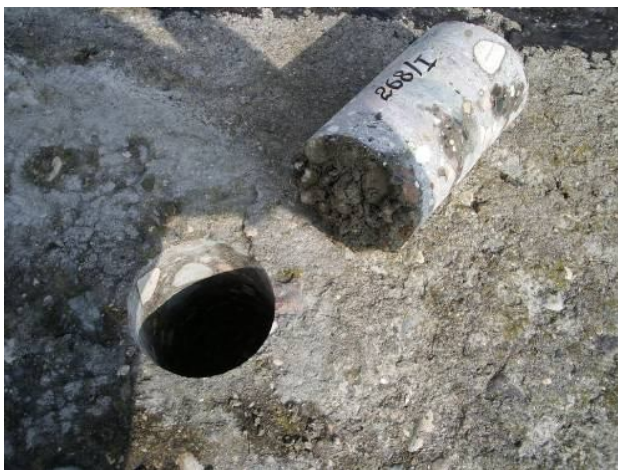
Рис. 6. Керн из монолитной бетонной плиты крепления грунтового откоса водохранилища. Состояние донной поверхности плиты – при бетонировании обратный фильтр вошёл в состав структуры бетона плиты
