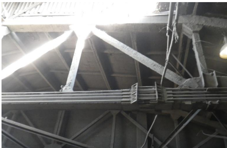
Рис. 9. Участок нижнего пояса железобетонной стропильной фермы, усиленной металлическими тяжами
