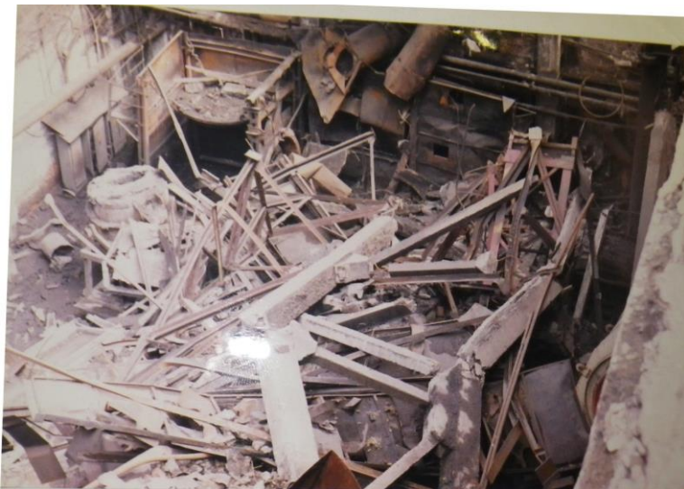
Рис. 5. Вид сверху на участок обрушения конструкций покрытия
