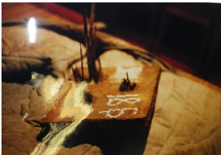
Рис. 8. Анкерная плита обрушившейся фермы. Коррозия пучков предварительно напрягаемой арматуры
