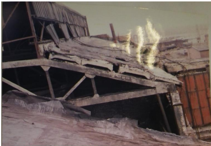
Рис. 7. Сдвиг плит покрытия с опорных узлов на прилегающем к зоне обрушения участке покрытия
