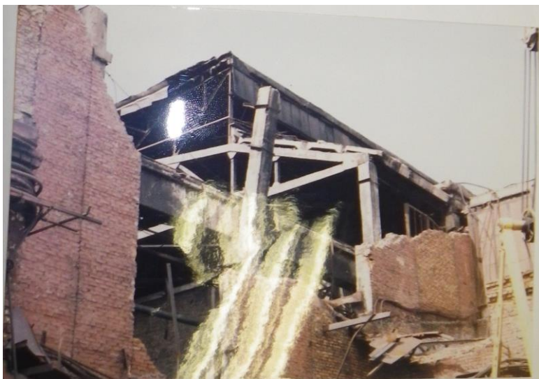
Рис. 6. Вид на участок обрушения со стороны разрушенной стены
