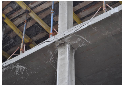
Рис. 3. Характер разрушения монолитной железобетонной плиты перекрытия второго этажа на стыке с колонной в осях Б-14
