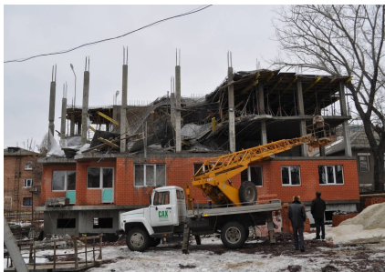
Рис. 2. Фасад в осях 1-16 жилого дома №27 по ул. Социалистической после обрушения плиты перекрытия второго этажа
