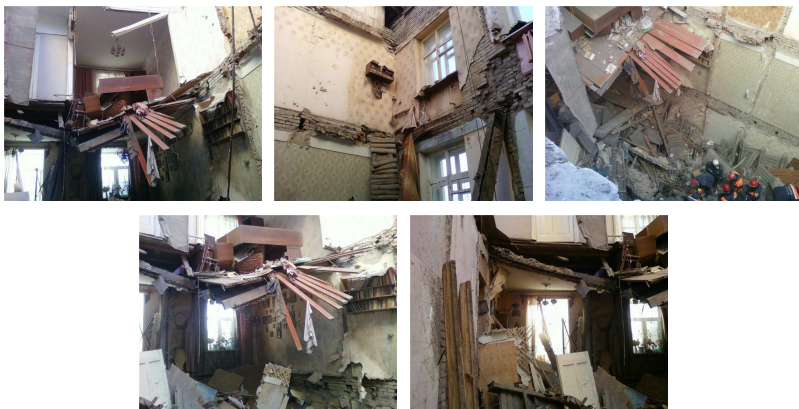
Рис. 2. Обрушение подъезда четырехэтажного жилого дома в Ярославле
