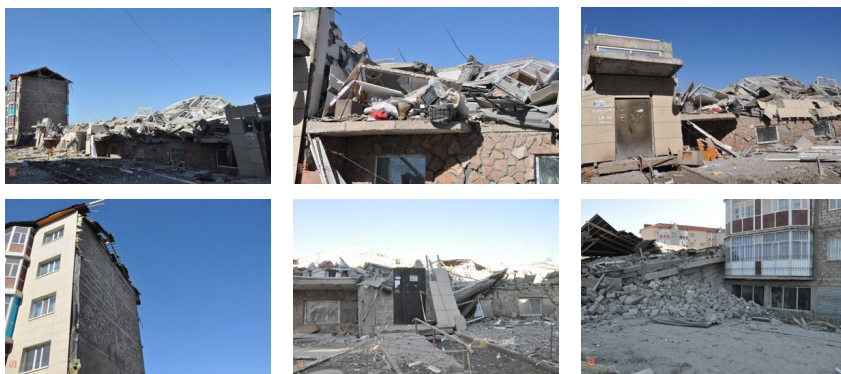
Рис. 1. Обрушение жилого дома в Караганде
