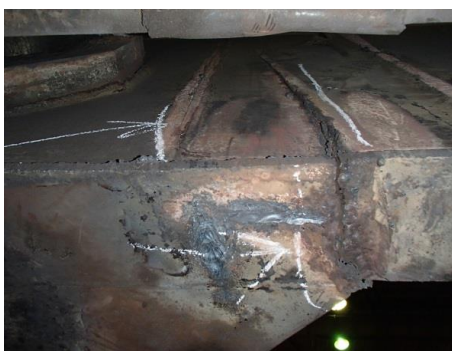
Фото 2. Ремонт, выполненный с явными нарушениями (неоднократными сварными швами по одному месту) и предьявленным положительным результатом ВИК этого шва
