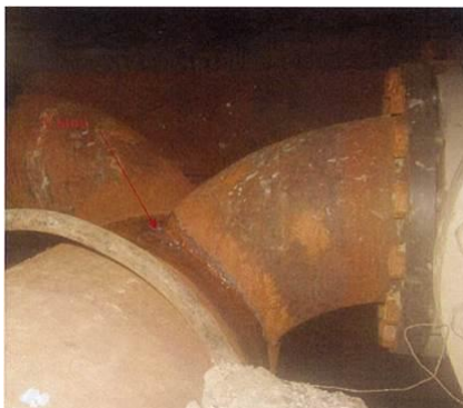
Рис. 1. Свищ в трубопроводе сетевой воды
