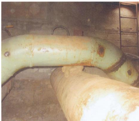
Рис. 6. Отсутствие тепловой изоляции на трубопроводе
