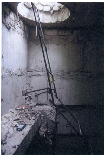
Рис. 5. Разрушение лестницы для спуска в тепловую камеру
