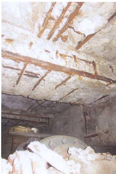
Рис. 4. Разрушение защитного слоя бетона с оголением и коррозией арматуры
