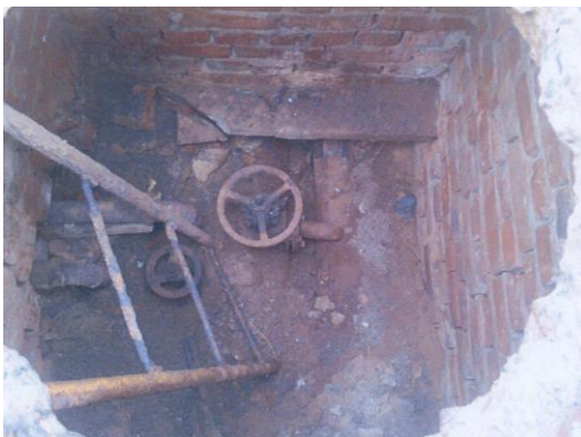
Рис. 2. Трубопровод тепловой сети в грунте
