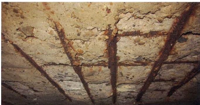
Рис. 3. Разрушение защитного слоя бетона с оголением и коррозией арматуры
