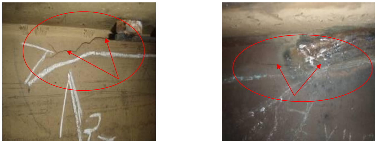
Рис. 1.24. Трещины в металле шва верхнего пояса с переходом в основной металл стенки подкрановых балок
