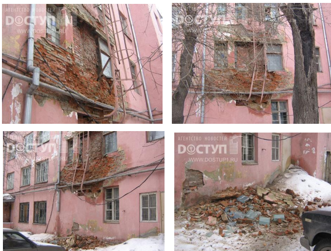
Обрушение кирпичной кладки фасада жилого пятиэтажного дома 29.03.2013 г. в г. Челябинск
