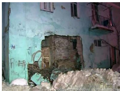
Обрушение несущей стены четырёхэтажного жилого дома 10.02.2013 г. в г.Красноармейск, Московская область
