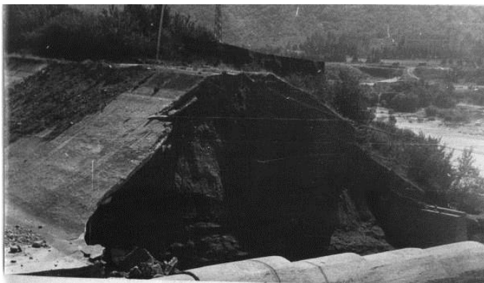
Рис.1. Разрушение насыпного борта деривационного канала Земо-Авчальской ГЭС над дюкером
