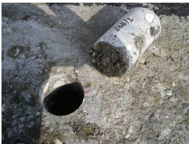
Рис. 6. Керн из монолитной бетонной плиты крепления грунтового откоса водохранилища. Состояние донной поверхности плиты – при бетонировании обратный фильтр вошёл в состав структуры бетона плиты
