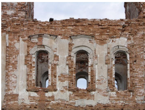
Рис. 2. Трещина в южной стене трапезной
