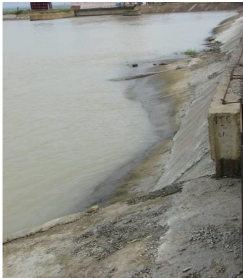
Рис. 4. Просадка плит участков крепления откоса, изменение профиля откоса
