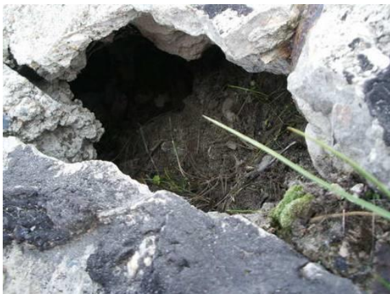
Рис.5. Осадка грунтового основания под плитой. Образование полости между плитой и основанием.
