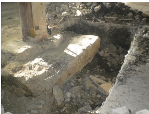
Рис. 2. Общий вид фундамента после вскрытия. В верхней зоне видны арматурные стержни
