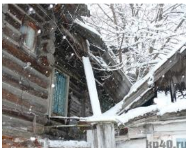
Рис. 3. Обрушение крыши деревянного муниципального дома 04.02.2013 г. в г.Калуге
