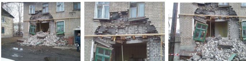
Обрушение стены жилого дома 21.04.2013 г. в г. Киров, Калужская область
