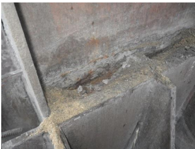
Рис. 5. Коррозия базы колонны в связи с потерей гидроизоляционных свойств материала заполнения внутренней полости
