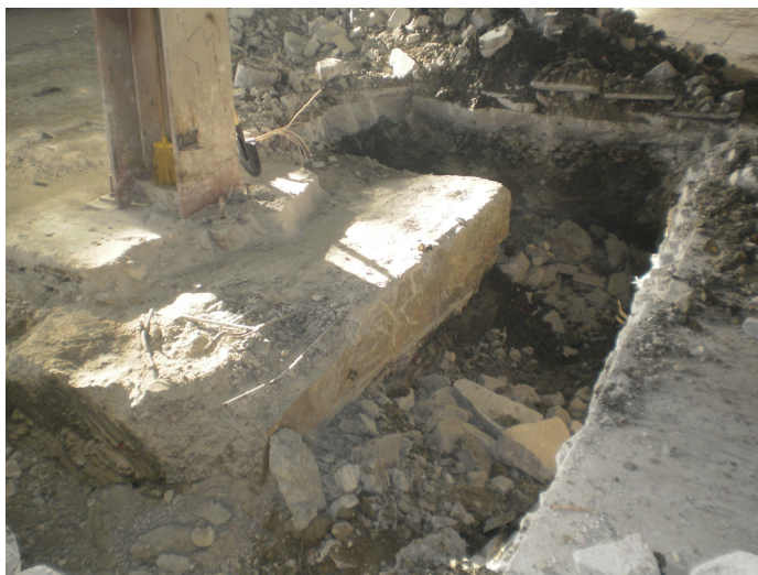
Рис. 2. Общий вид фундамента после вскрытия. В верхней зоне видны арматурные стержни
