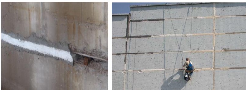
Рис. 1. Некачественный межпанельный шов и его ремонт
