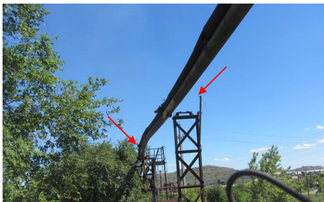
Фото 2. Смещение с опор газопровода и гибь труб в результате механического воздействия (данный участок газопровода располагается над дорогой)
