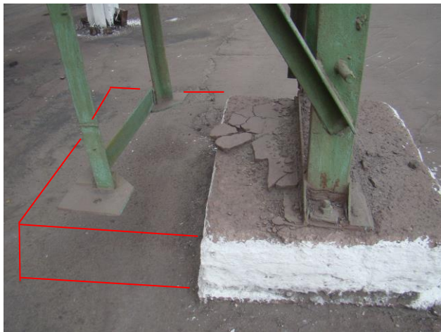
Фото 1. Отсутствие фундамента под опорой газопровода
